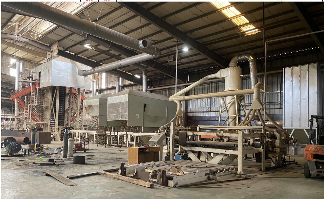
拌胶、铺装、预压、热压、凉板工序及其输送过程废气收集装置图及现场图
