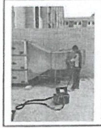
厨房油烟废气处理前
