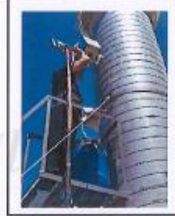
喷底漆及其自然晾干工序废气排放口
