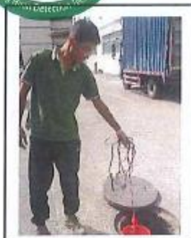
生活污水排放口
