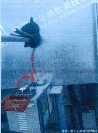
涂布、烘干工序废气处理前
