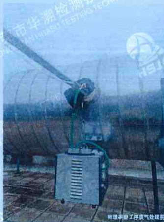
物理研磨工序废气处理前
