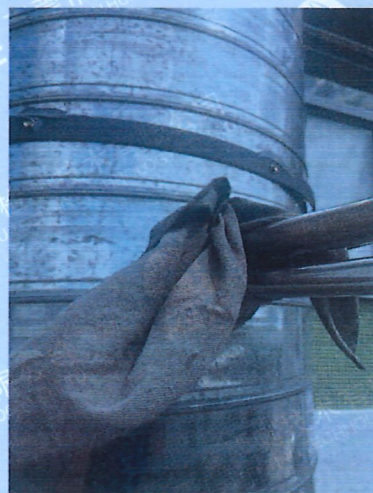
粗搅拌、研磨、细搅拌、清洗 废气、涂膜、烘干工序废气 排放口
