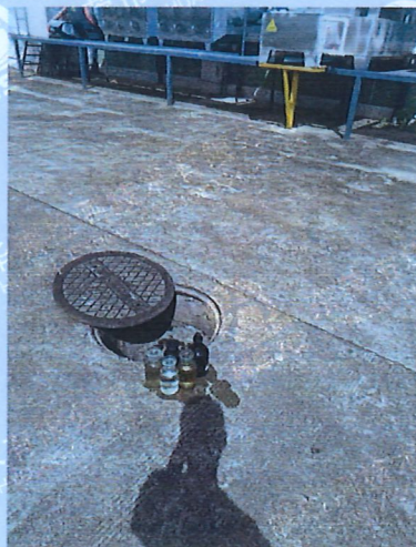
生活污水排放口
