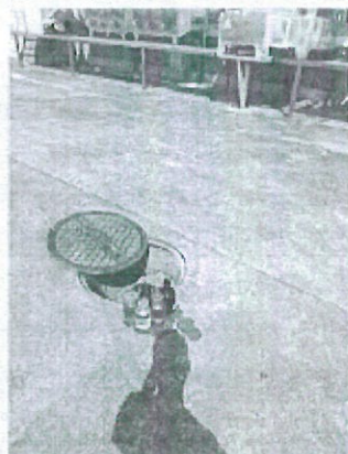
生活污水排放口
