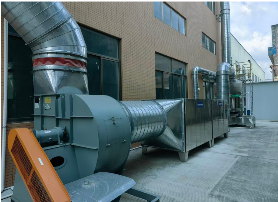
图 3-2 废气治理设施
